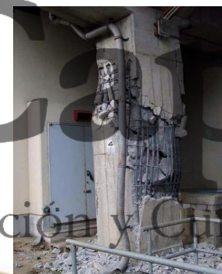
Falla por flexo compresión
