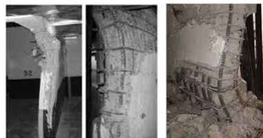
Falla por pandeo
