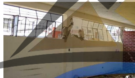
Falla por columna corta
